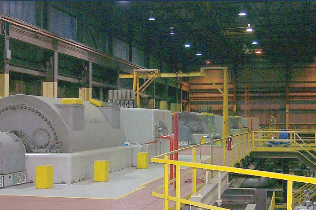
Geradores de nível 2 com tubagem de recolha de amostras VESDA numa área protegida, e unidade de detecção montada num compartimento de controlo para fácil acesso e manutenção.
